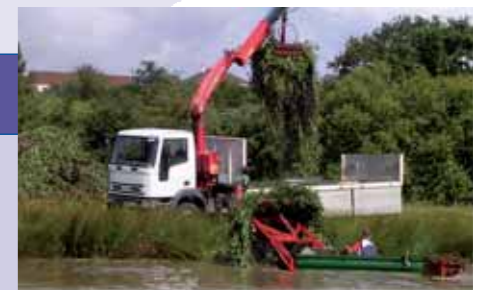
Les arrachages mécaniques se font grâce à des matériels spécialisés et à des grues.
